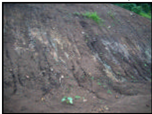
Erosion d'un talus de déblai
